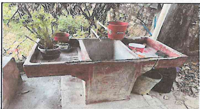
Foto 3: PILA EN MAL ESTADO
