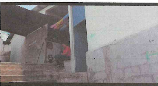
Foto 6: PINTURA EN MAL ESTADO
