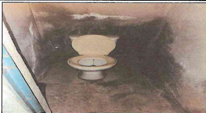
Foto1: SANITARIOS EN MAL ESTADO
